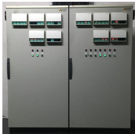
Controlador y módulos ubiados en cuadro eléctrico
