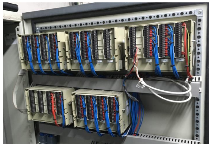
Cableado interior del cuadro de la zona sureste/ este / Salón de Sesiones.
